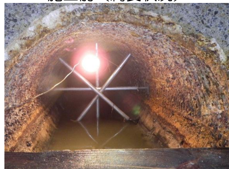
施工前（腐食状況）
